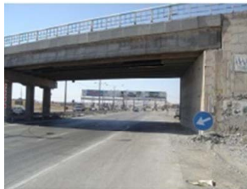
شکل ۳-۳۸- آشکارسازی نامناسب سازه
